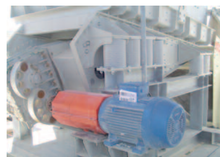
Bunkerabzugseinheit mit Richterregereinheit
